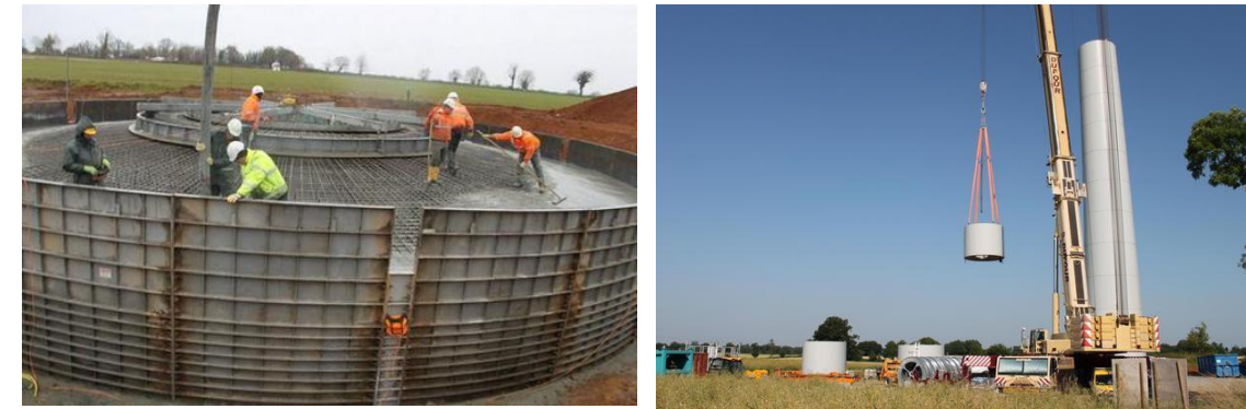
Construction du parc éolien de Champdeniers St Denis – source La Nouvelle République 2013
